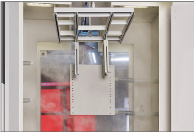
Automatische Pulverbeschichtungsanlage mit insgesamt 4 Beschichtungskabinen.
